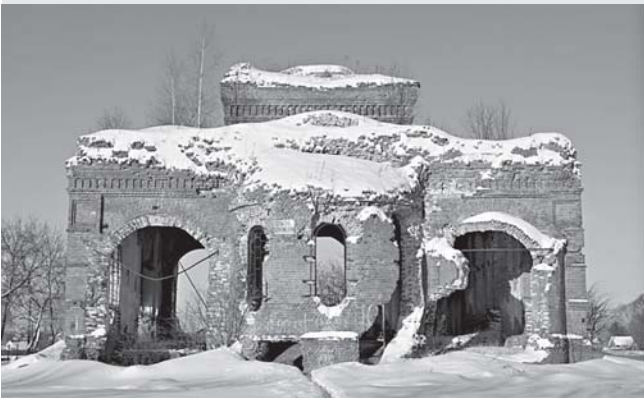
Большинство пустующих разрушенных храмов — результат «хрущевской» волны гонений на церковь
